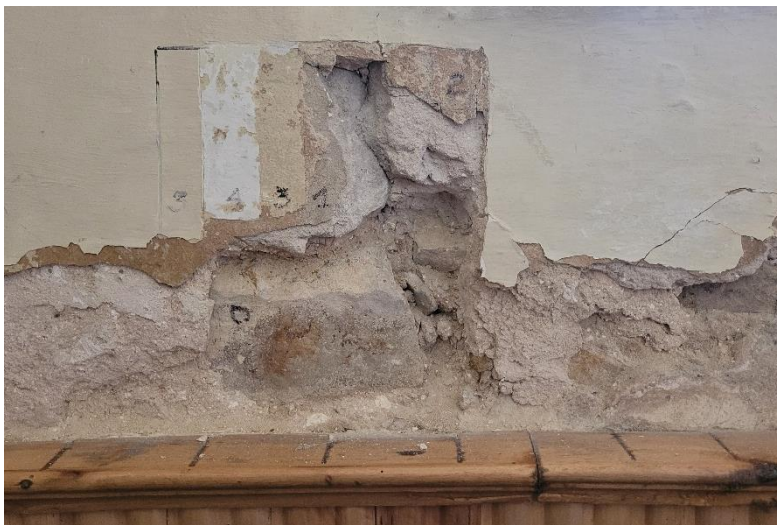
Fot.25. Wykonana odkrywka stratygraficzna w miejscu ubytku tynku nad boazerią Tynk z widocznymi odspojeniami, malatura z przetarciami
