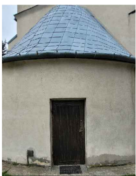
drzwi wejściowe do zakrystii z widoczną rysą tynku od dachu do nadproża; przy styku dachu namiotowego z murem widoczna źle wykonana obróbka blacharska
