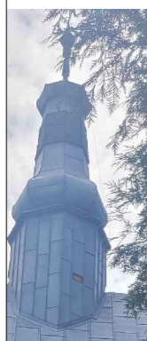
sygnaturka z widocznym ubytkiem pokrycia
