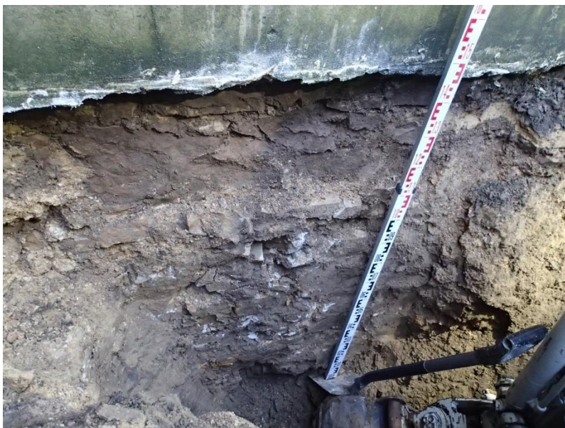
Fot.2. Odkrywka fundamentów przy ścianie nawy głównej, również brak zarysowania ściany fundamentowej.
