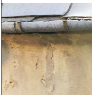
stan zachowania tynku z wyprawą malarską; widoczne odspojenia i spruchnienia wyprawy w pasie podgzymsowym
