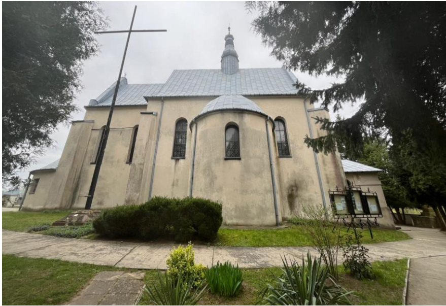
Fot 10. Elewacja północno-zachodnia z widoczną sygnaturką; widoczny zróżnicowany stan tynków elewacji Krzyż misyjny na pierwszym planie
