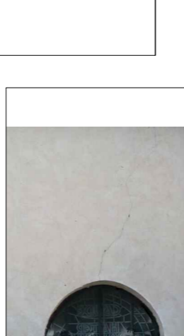
rysa nad oknem, od gzymsu do nadproża
