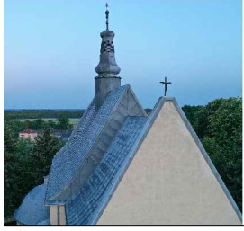
ściana szczytowa prezbiterium z widocznym rozwarstwieniem tynku, w tle widoczna obróbka blacharska ściany szczytowej dachu nad nawą główną
