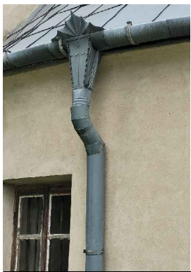
spust z blachy tytan-cynk ze zdobieniem; połączenie rynny ze spustem nieszczelne; rynna pocięta na całej długości; nad oknem widoczna rysa ciągnąca się od fasety gzymsu
