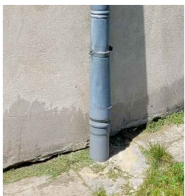
wpust PCV, brak rewizji; odcięcie tynku nad gruntem źle wykonane
