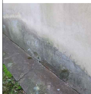
porażenie tynku przy styku z gruntem; widoczne rozwarstwienie struktury
