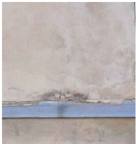
odspojenia tynku na całej długości styku opierzenia fasety gzymsu z murem
