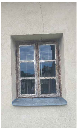
rysa konstrukcyjna od poziomu dachu; skrzydło okienne ze złuszczoną farbą, szklenie z licznymi ubytkami kitu
