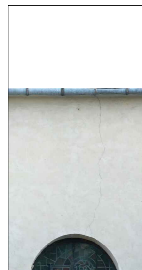
rysa nad oknem, od gzymsu do nadproża
