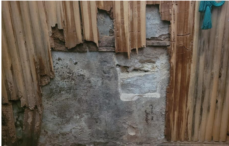
Fot.24. Sinica partii cokołowej boazerii z widocznym ubytkiem Mur za boazerią w stanie porażenia biologicznego
