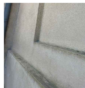
stan zachowania tynku kruchty; w głębi widoczne pęknięcia technologiczne tynku na całej długości w miejscu styku kruchty z bryłą główną kościoła
