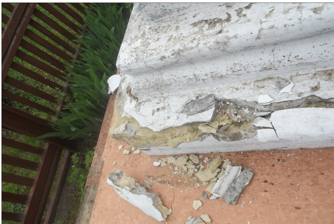
8. Uszkodzony cokół kolumny. Widoczne liczne spekania i odpadnięcia wyprawy cementowej. Miejscowe uszkodzenia kamienia.
