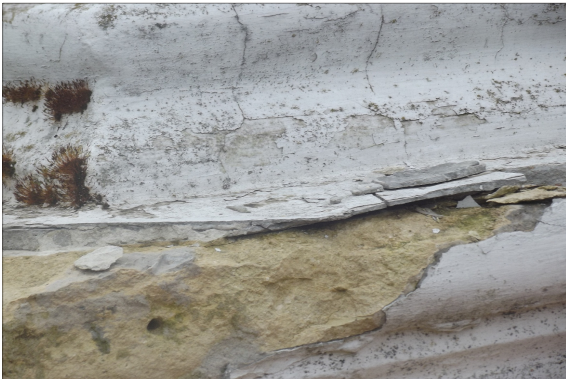
10. Uszkodzony cokół kolumny. Widoczne ślady nieprofesjonalnych napraw, spękania oraz korozja biologiczna.
