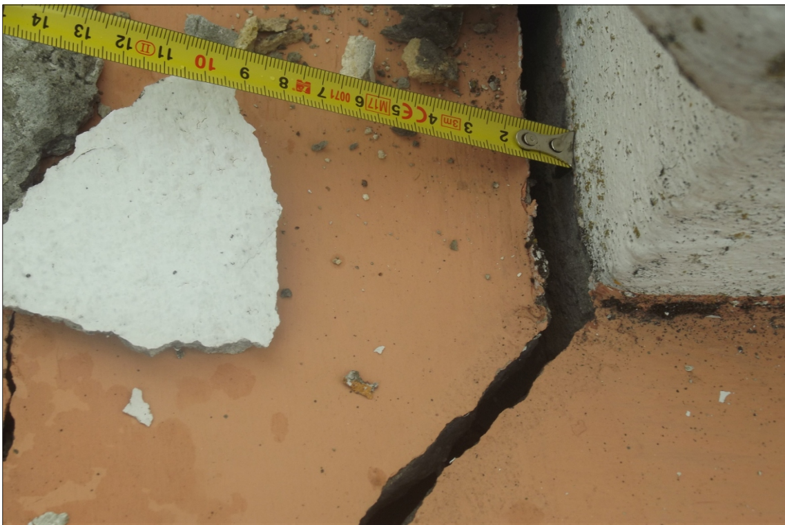
12. Uszkodzenie wyprawy betonowej nałożonej na kamienną podstawę kolumny.
