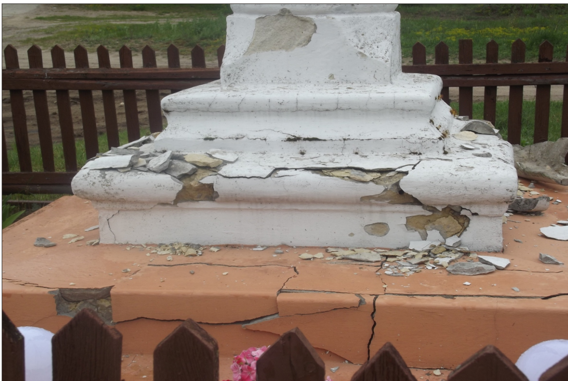
3. Podstawa betonowa oraz cokół kolumny. Widoczne liczne uszkodzenia, spękania i ubytki substancji, nieudolnie uzupełnianej zaprawą cementową.
