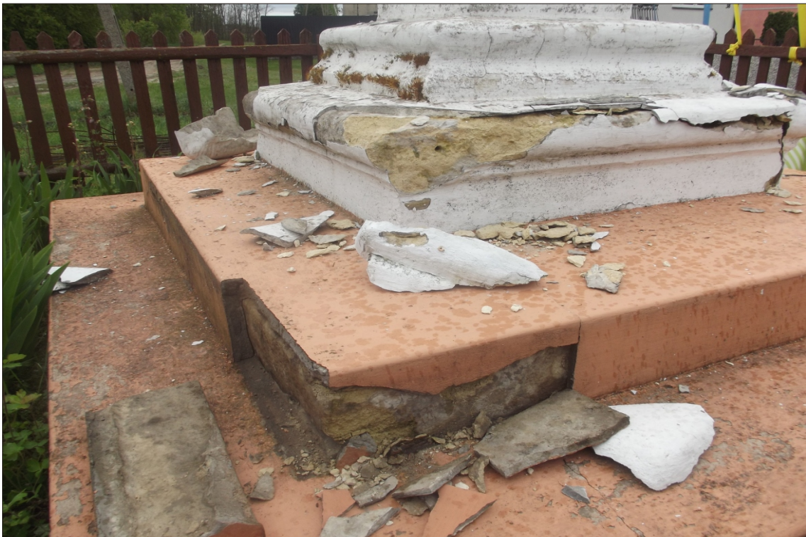
5. Dwustopniowa podstawa kolumny wraz z cokółem. Widoczny odsłonięty spod kilku centymetrowej warstwy betonu oryginalny materiał stopni. Cokół kolumny spękany, widoczne odpadnięcia wyprawy cementowej oraz uszkodzenia oryginalnego kamiennego cokołu.
