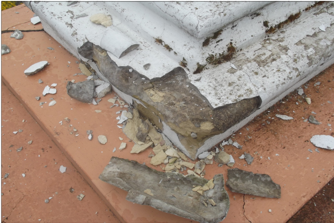
4. Cokół kolumny pokryty wtórną warstwą betonową. Widoczne liczne spękania, odspojenia oraz destrukcja oryginalnego wtku kamiennego.
