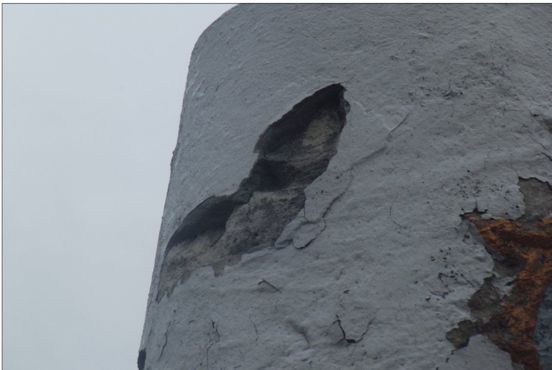
13. Uszkodzony mechanicznie trzon kolumny.
