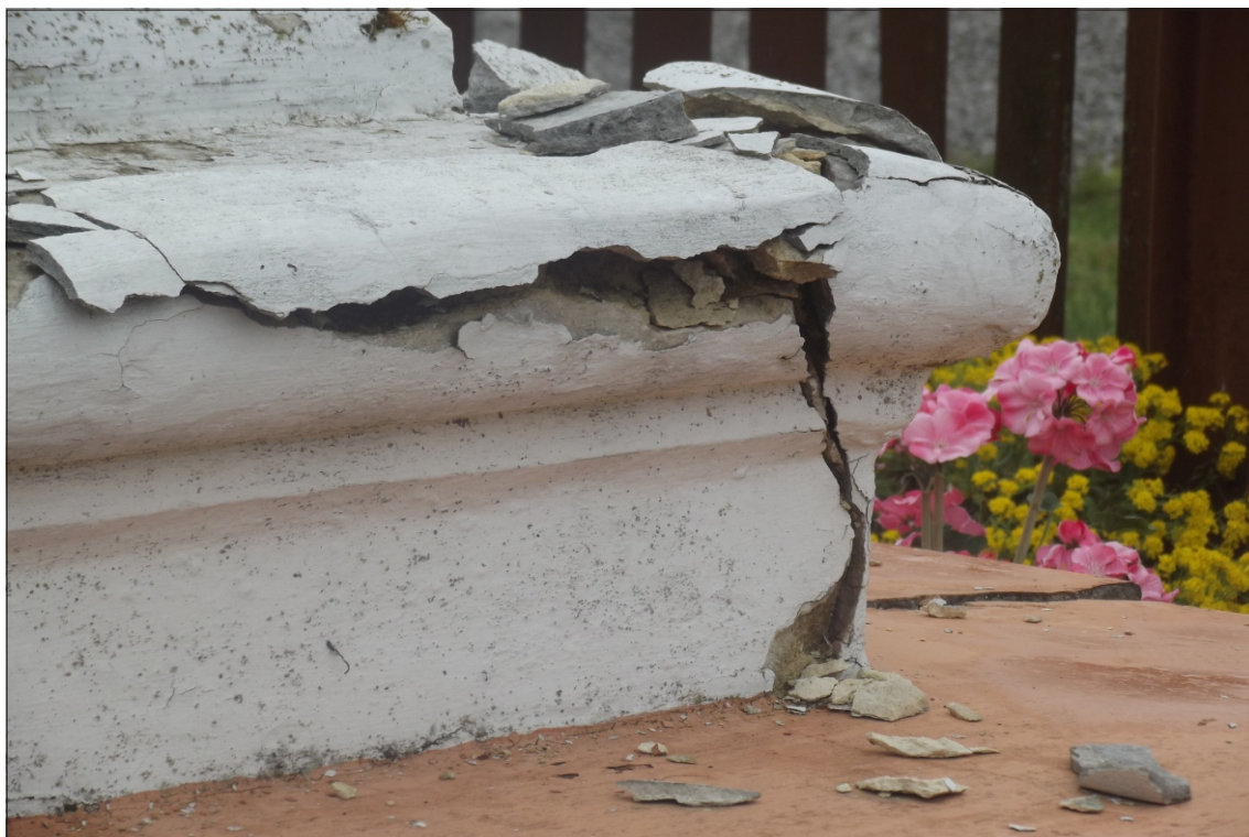
7. Cokół kolumny z widocznymi uszkodzeniami.
