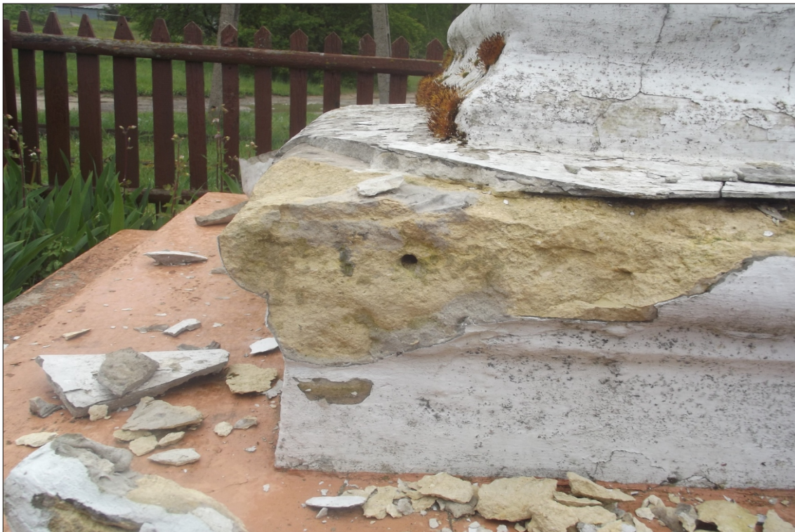
9. Uszkodzony cokół kolumny. Widoczne ślady nieprofesjonalnych napraw, spękania oraz korozja biologiczna.
