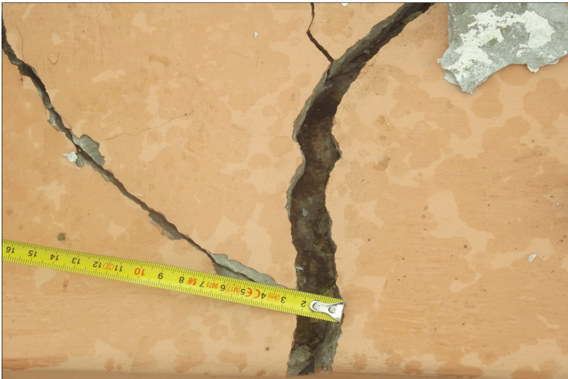
11. Uszkodzenie wyprawy betonowej nałożonej na kamienną podstawę kolumny.
